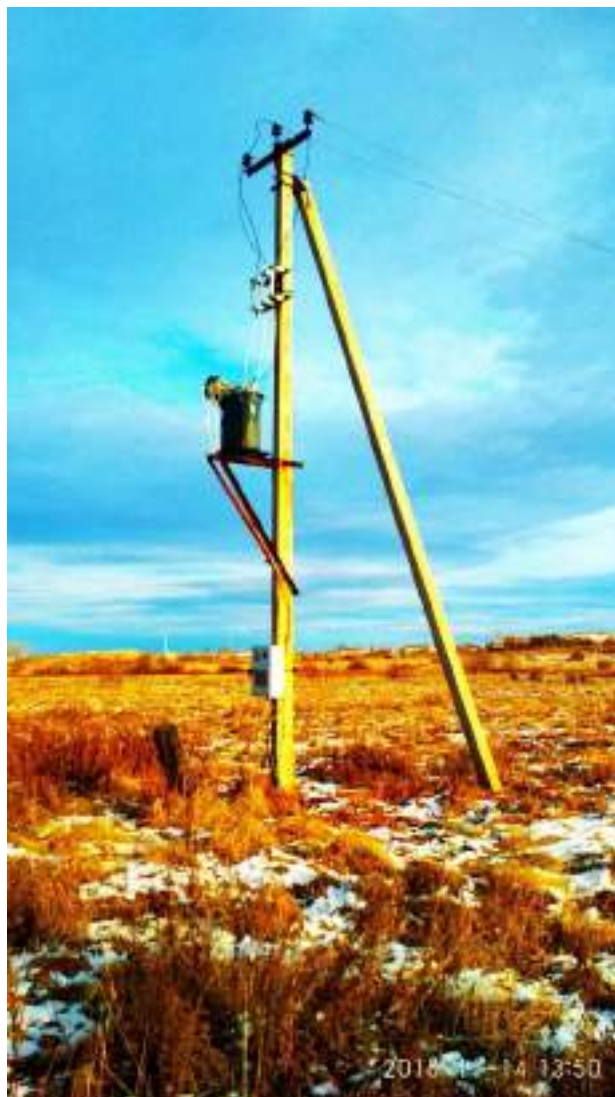
Рисунок 3. Прибор учета электрической энергии
