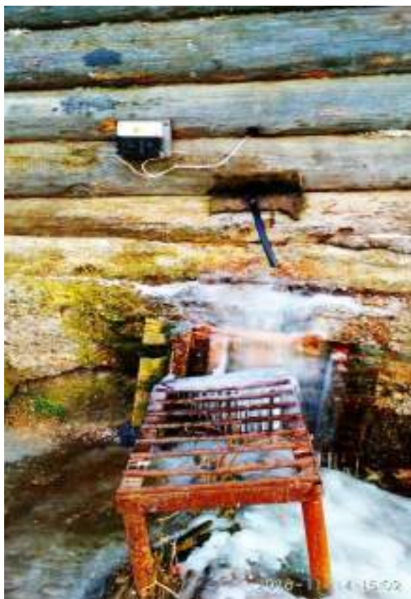
Рисунок 8. Прибор учета потребления электрической энергии скважины по ул. Пионерская, 54
