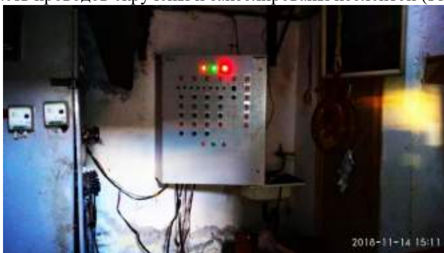
Рисунок 32. Шкаф управления КНС №6
