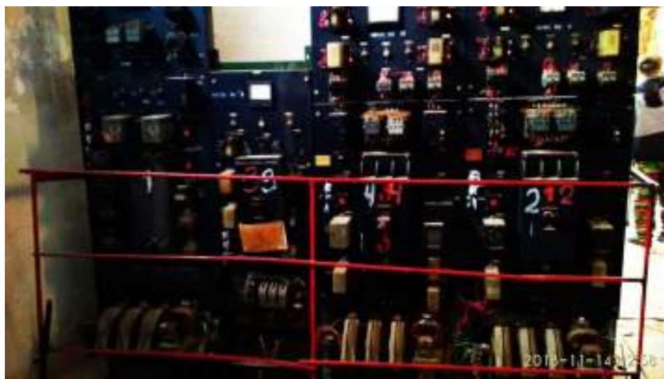
Рисунок 25. Шкаф управления КНС №4
