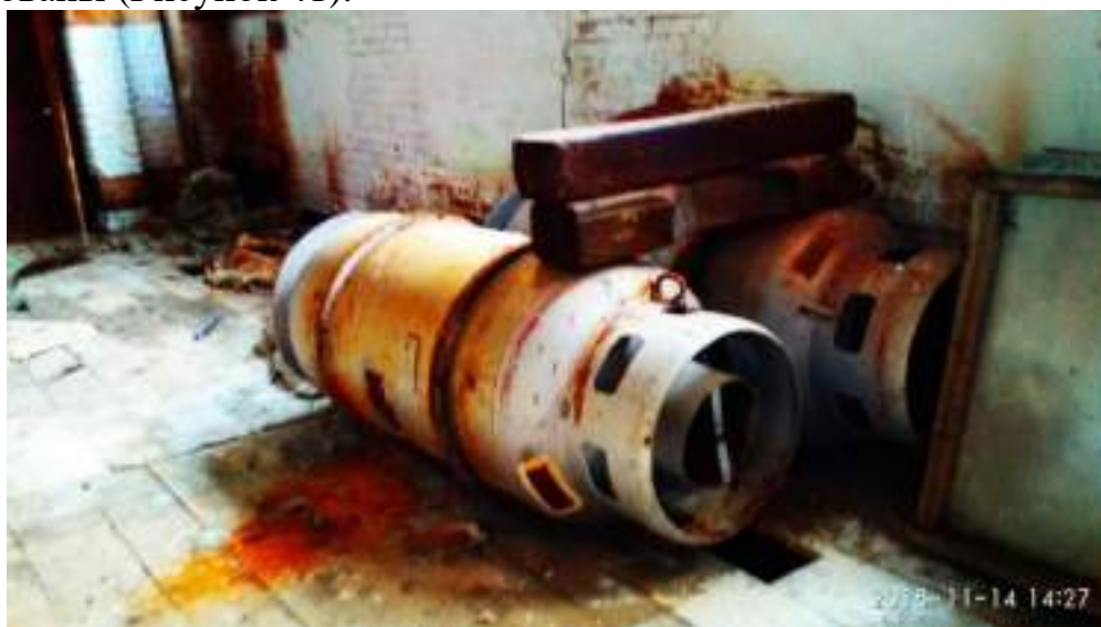
Рисунок 41. Баки хлорирования и очистки
