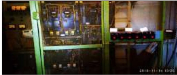
Рисунок 21. Шкаф управления КНС №3
