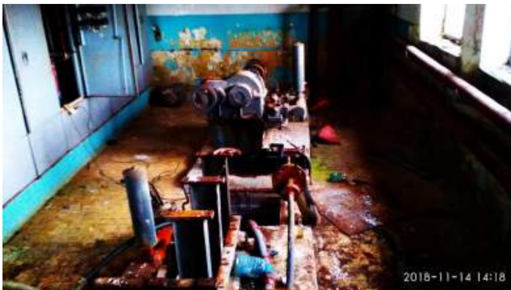
Рисунок 35. Насосный агрегат насосной стоков возврата иловой воды и насосной станции сырого осадка
