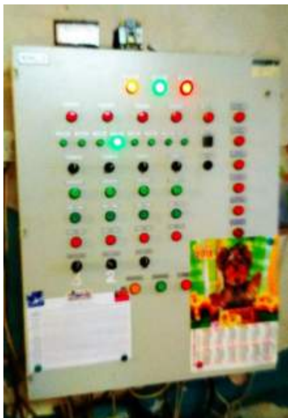
Рисунок 19. Шкаф управления КНС №2
