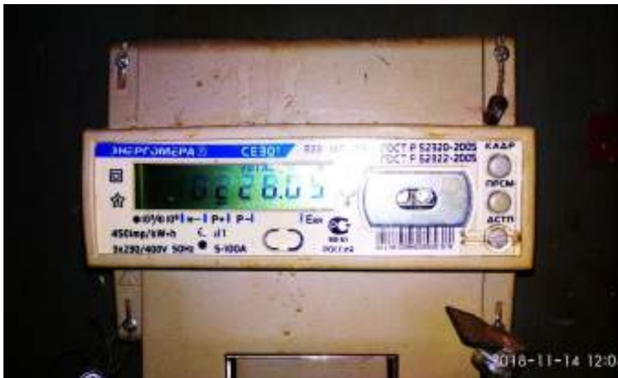
Рисунок 12. Прибор учета электрической энергии на КНС №1
