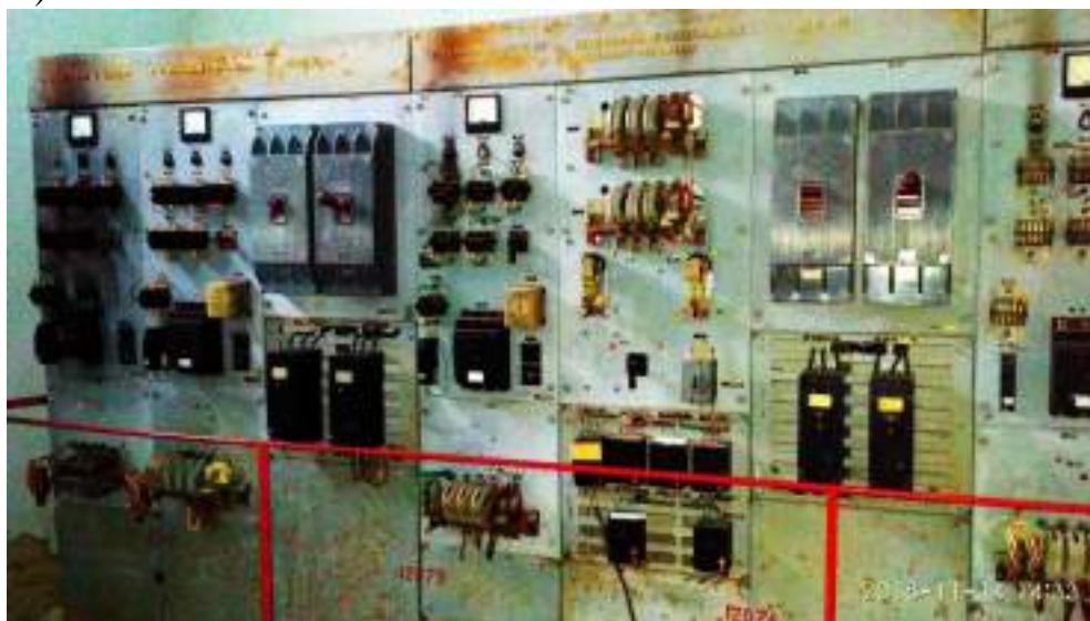
Рисунок 46. Щит управления насосной станции перекачки очищенных стоков
