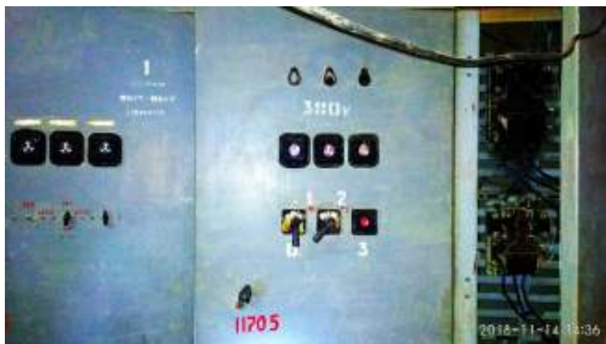
Рисунок 50. Щит управления насосной станции бытовых стоков (дренажные очистные сооружения)
