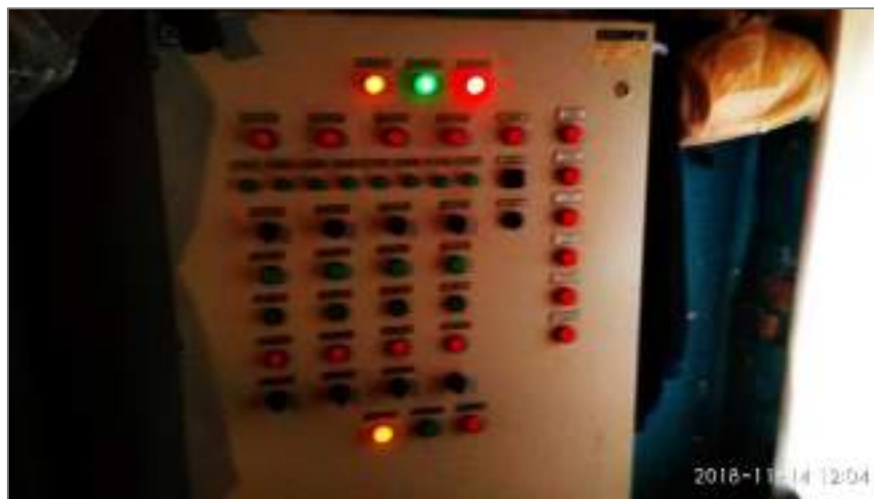
Рисунок 13. Шкаф управления КНС №1
