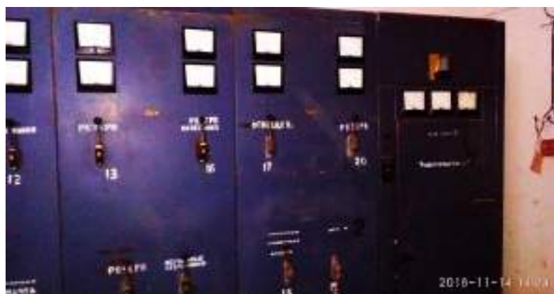
Рисунок 39. Щиты управления здания воздухоудвки
