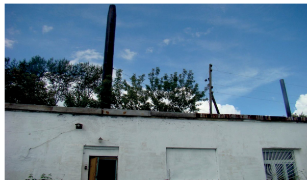
Рисунок 7. Общий вид котельной по ул. Первомайская, 28
