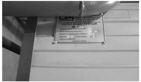
Рисунок 11. Общий вид водогрейного котла КВР-0,5
