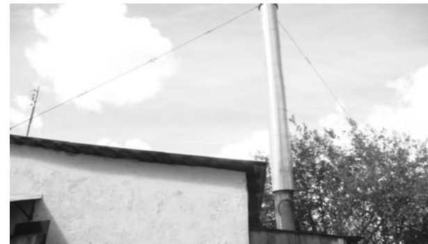
Рисунок 9. Общий вид котельной по ул. Карла Маркса, 35
