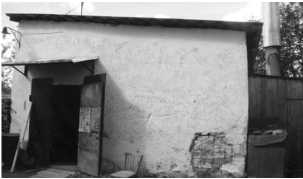
Рисунок 10. Общий вид котельной по ул. Карла Маркса, 35
