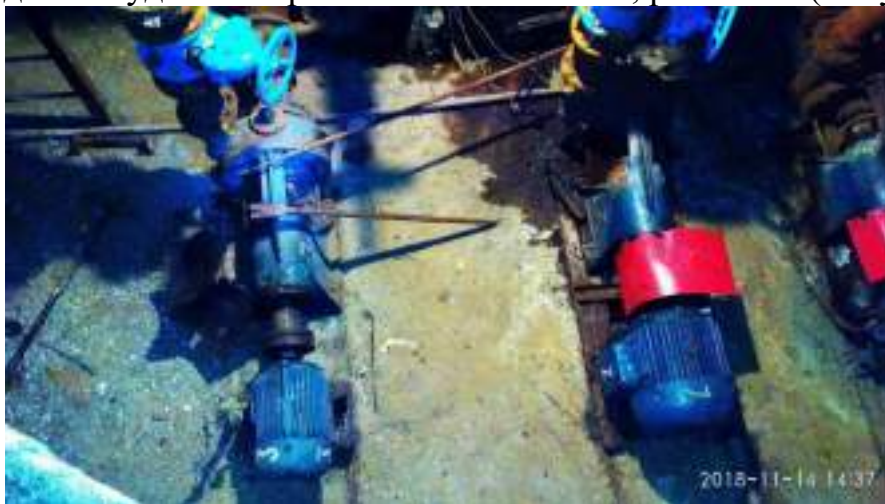
Рисунок 48. Насосное оборудование насосной станции бытовых стоков (дренажные очистные сооружения)
