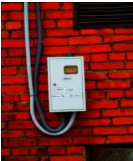
Рисунок 17. Прибор учета электрической энергии на КНС №2
