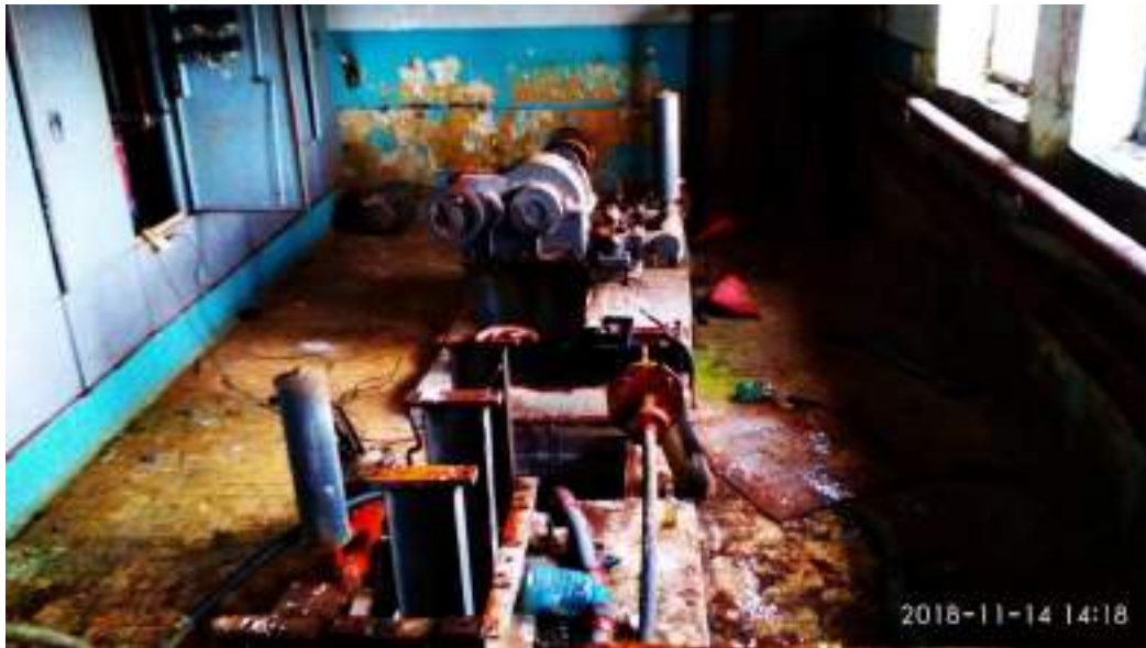
Рисунок 35. Насосный агрегат насосной стоков возврата иловой воды и насосной станции сырого осадка
