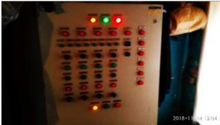
Рисунок 13. Шкаф управления КНС №1
