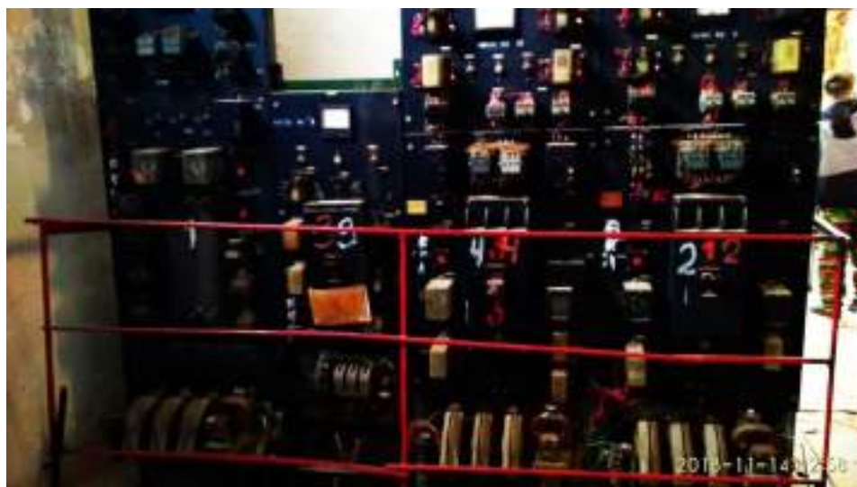
Рисунок 25. Шкаф управления КНС №4
