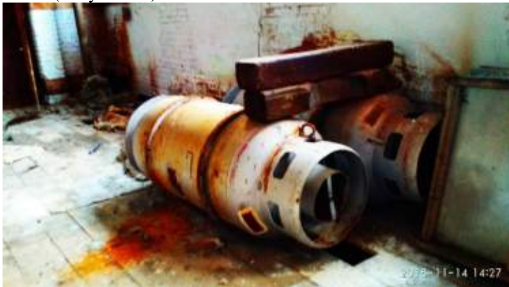
Рисунок 41. Баки хлорирования и очистки
