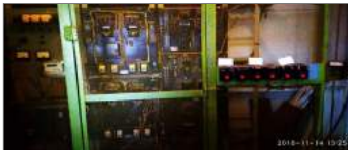
Рисунок 21. Шкаф управления КНС №3
