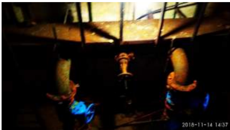
Рисунок 49. Трубопроводы насосной станции бытовых стоков (дренажные очистные сооружения)
