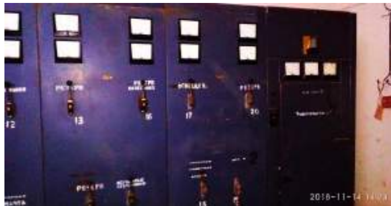
Рисунок 39. Щиты управления здания воздухоудвки
