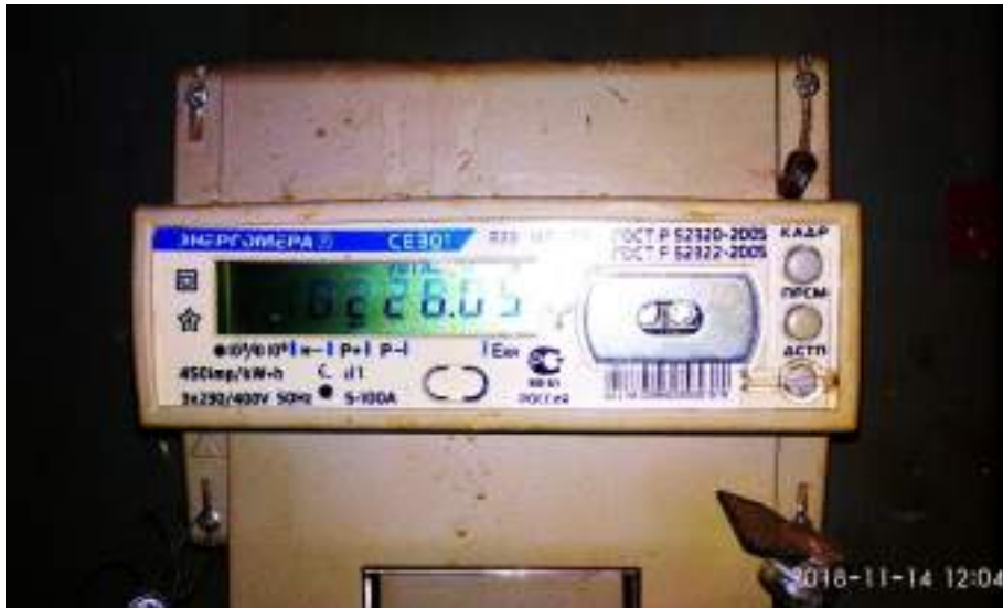
Рисунок 12. Прибор учета электрической энергии на КНС №1
