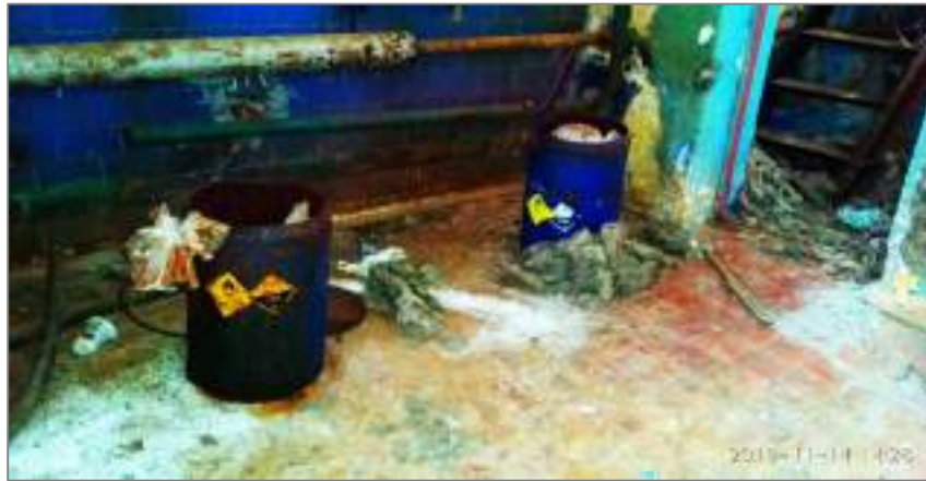
Рисунок 40. Здание хлораторной (внутри)
